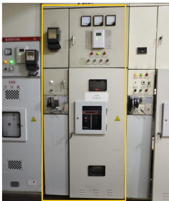
图 2 104#润磨机配电柜
