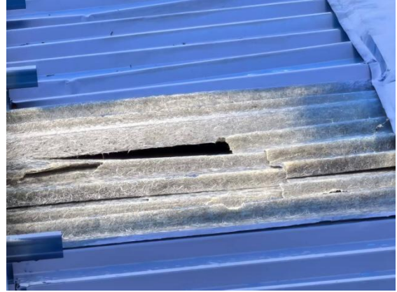
图2 破损采光带情况
