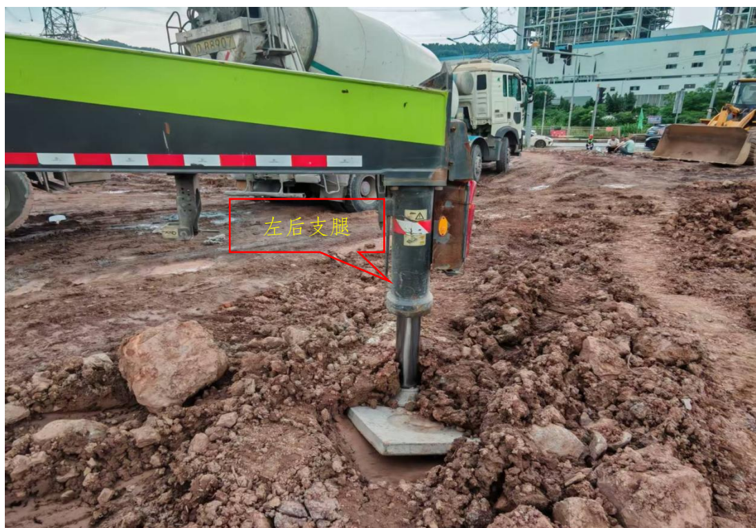
图 7（事发后泵车左后支腿支撑状态）
