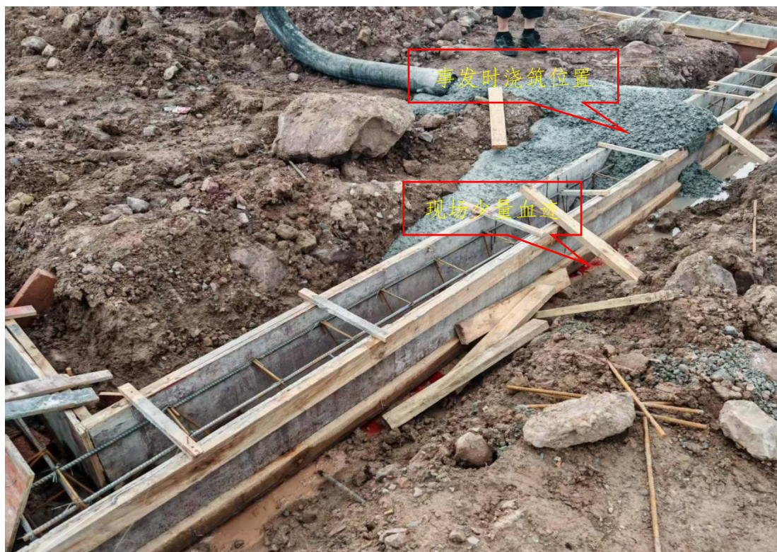
图 3（事故发生现场正视图）
