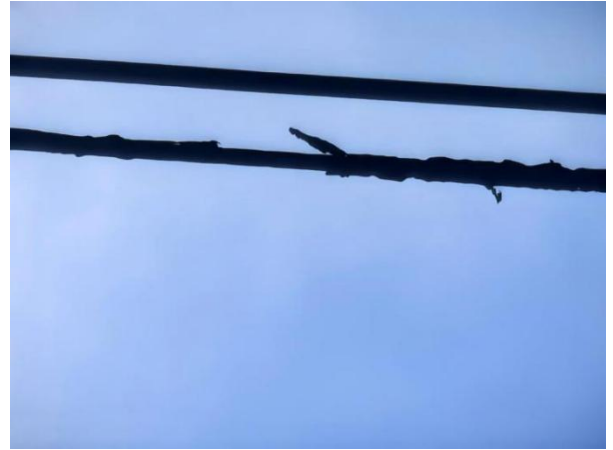
（高压电线绝缘破损情况）
