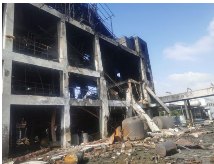
上图为事故后的 T04 车间
