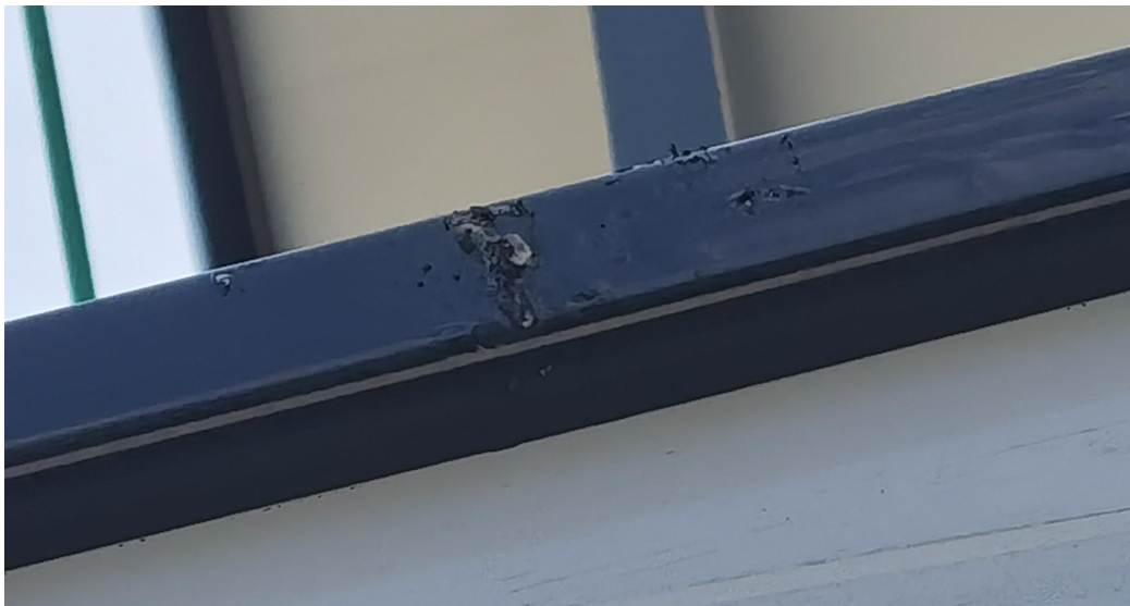
(见图 4，事故发生部位断落铁片的位置)
