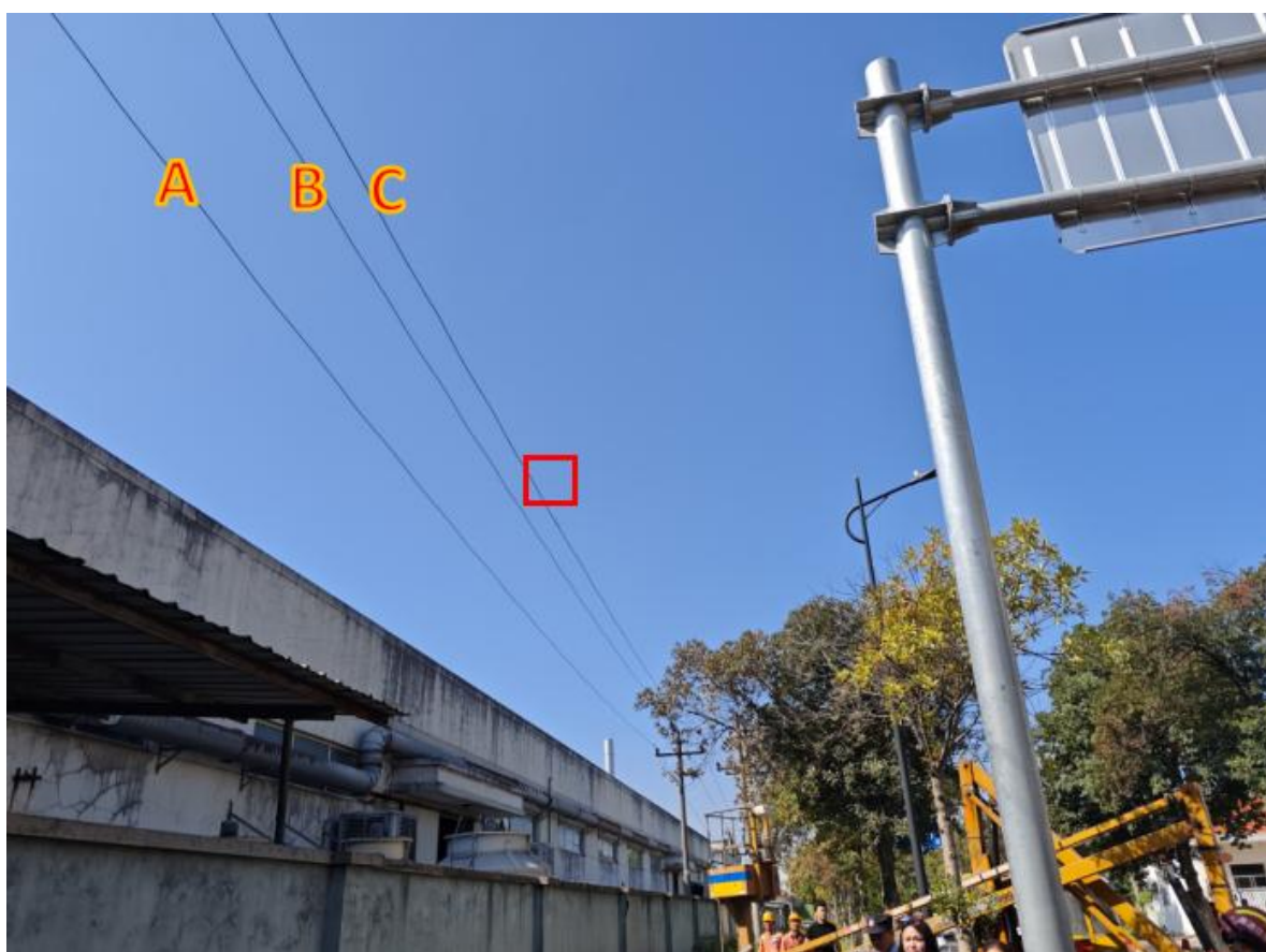
图 1 事故现场图片，红框部位为涉事人员触碰导线位置。
