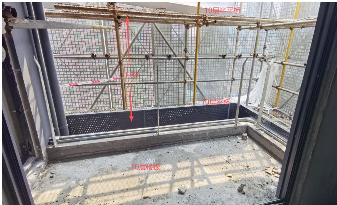
图6 事发平桥与室内高差情况
