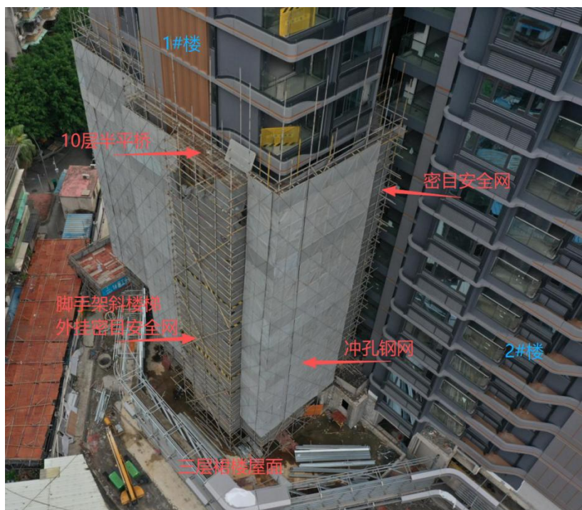
图3 事发1#楼脚手架情况
